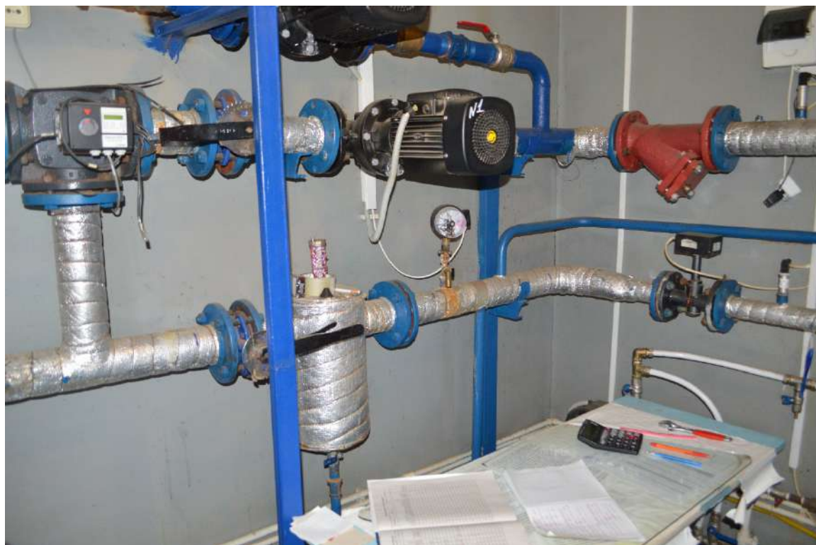
Фото Ф2 оборудование котельной.
