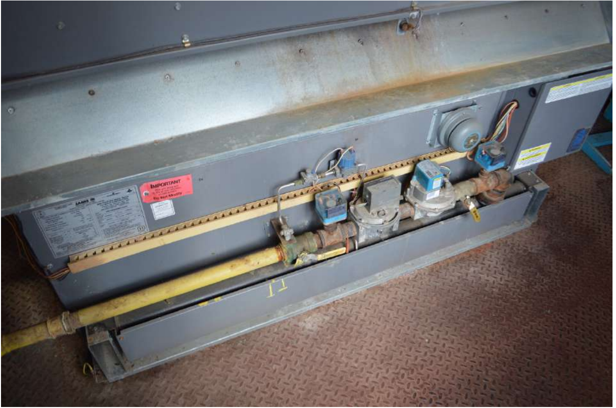
Фото Ф5 оборудование котельной.
