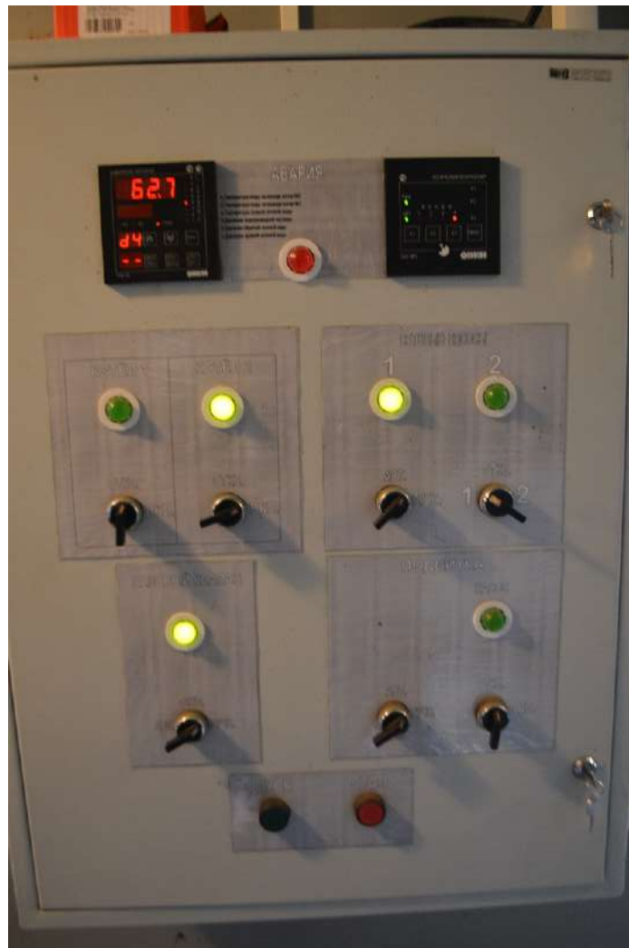
Фото Ф4 оборудование котельной.
