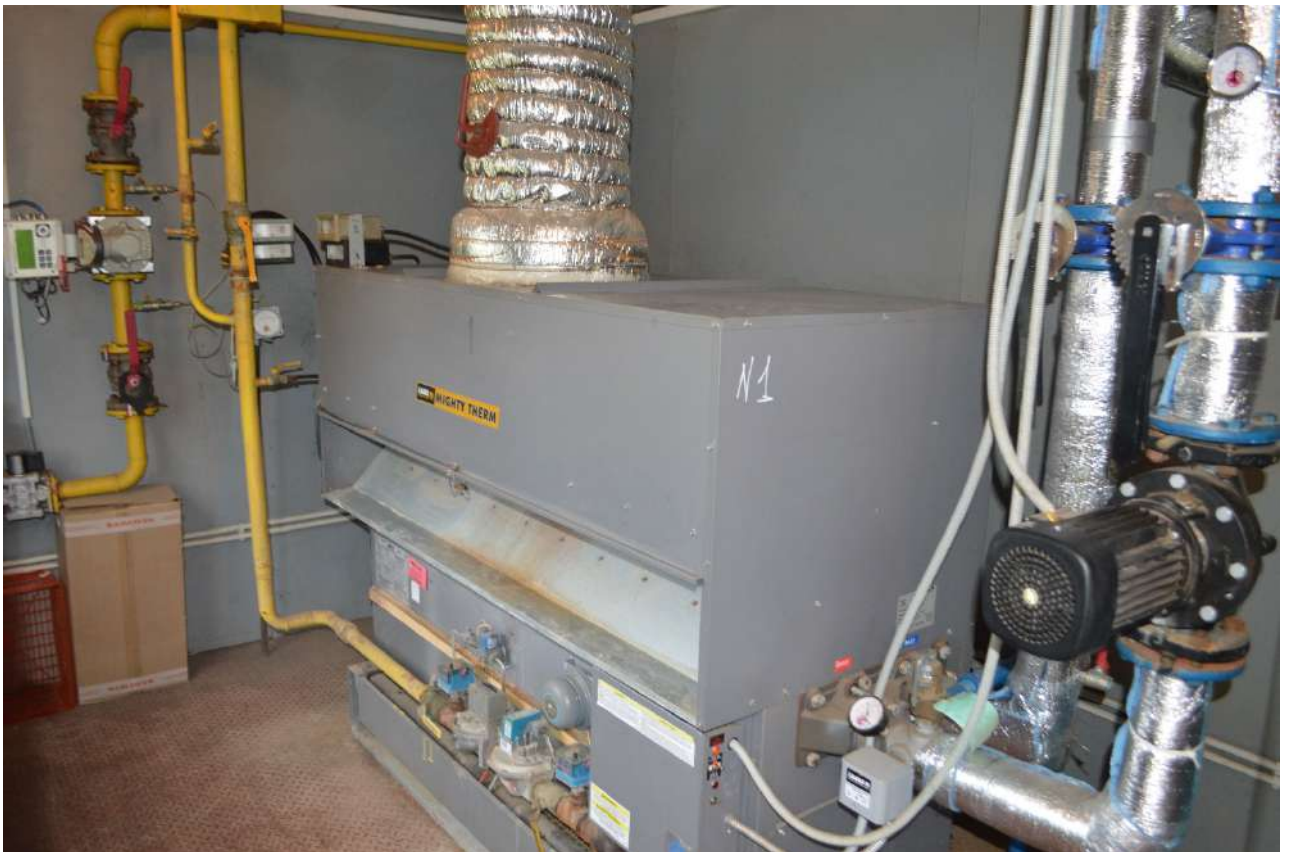
Фото Ф6 оборудование котельной.
