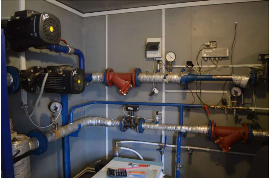
Фото Ф3 оборудование котельной.
